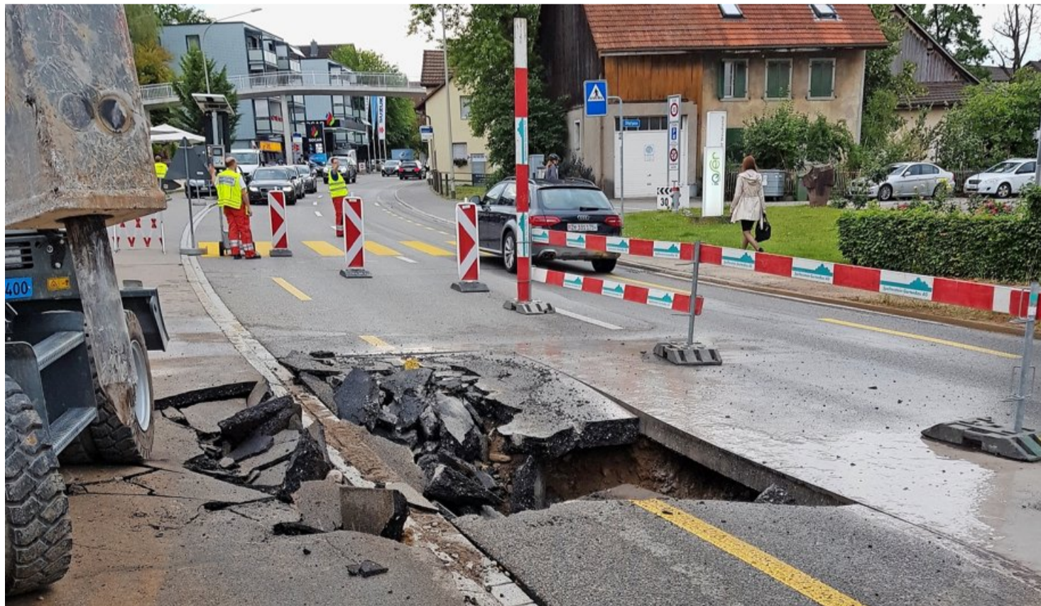
Auf der Klotenerstrasse in Bassersdorf sorgt ein Wasserrohrbruch für Verkehrsbehinderungen.
